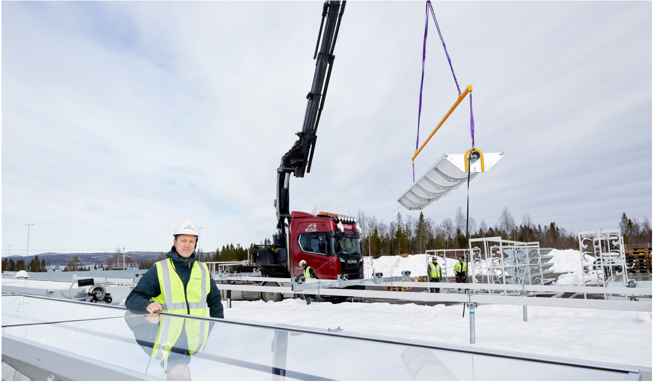
Benjamin Ahlgren, projektledare, för Högslätten Solar Thermal Park 2023, vid installationen av fas 1 i Härnösand. Foto: Tarek Suleiman
