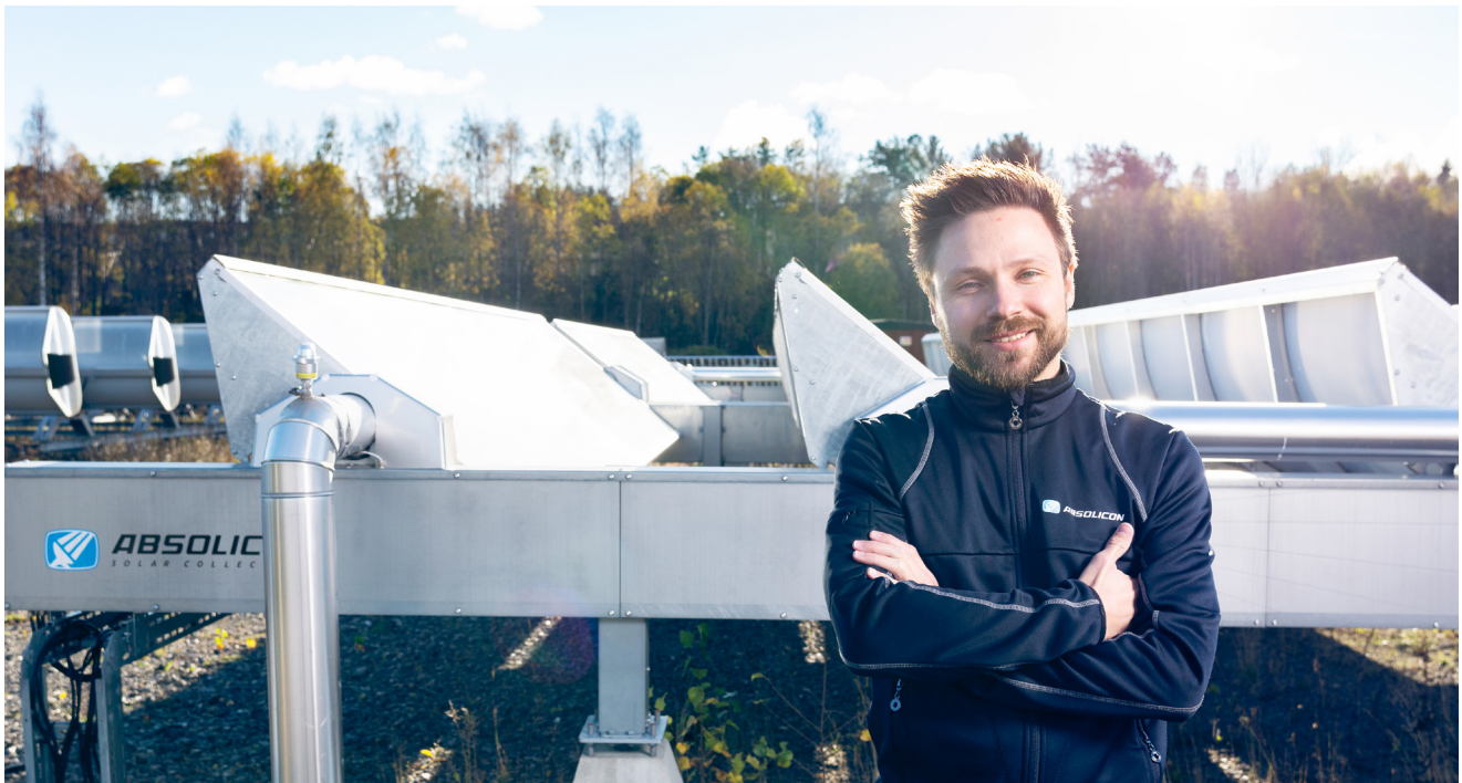
Loick Bruand, servicetekniker på Absolicon, vid en av installationerna i Härnösand. Foto: Tarek Suleiman
