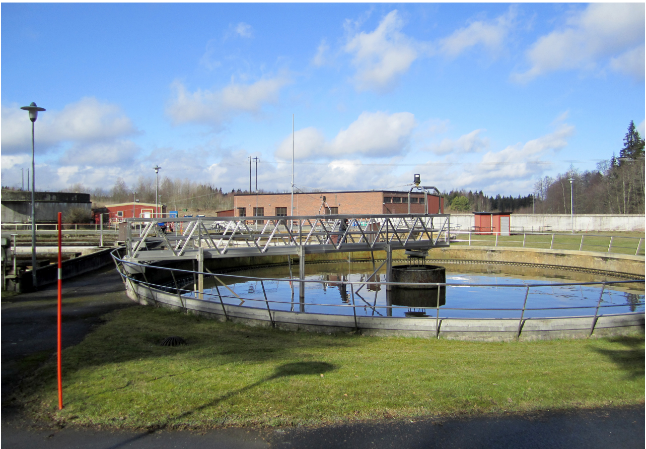
VA-verk i Nässjö, VA står för Vatten & Avlopp. Foto NFO.
